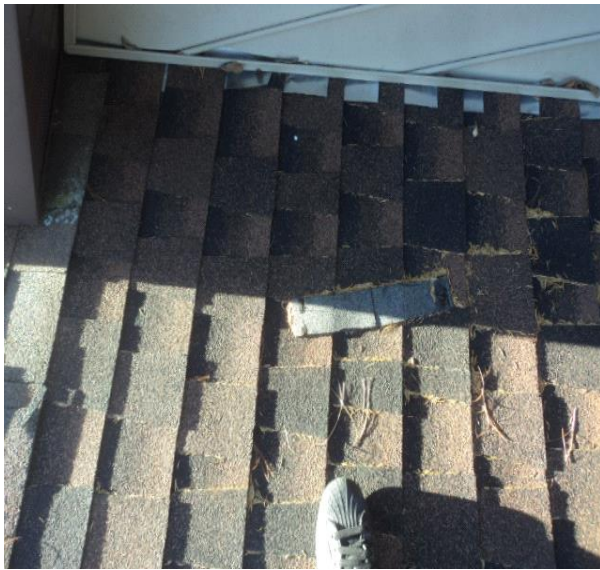
DSC06468.JPG Missing shingles.
